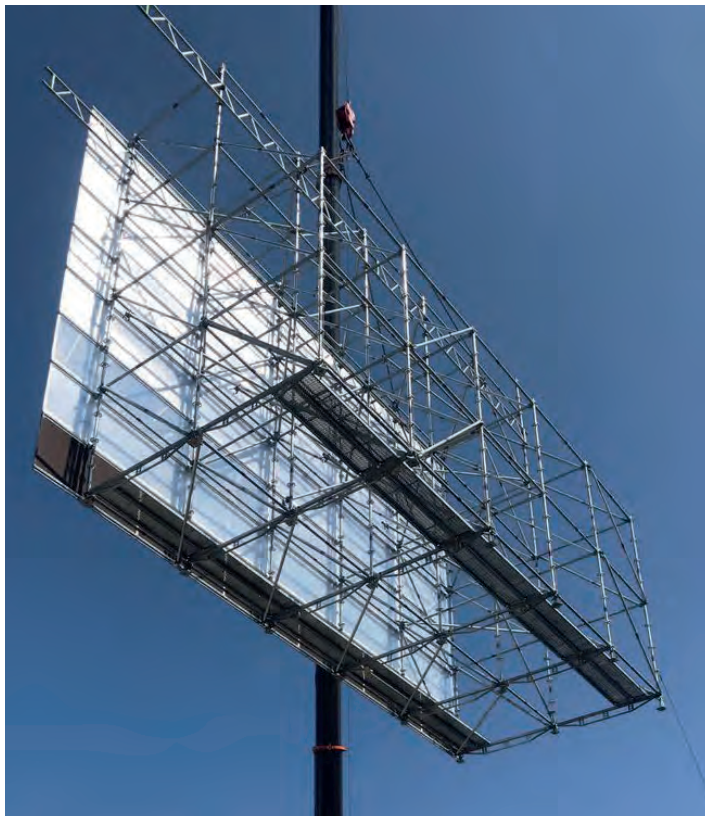
Komplettversatz eines RINGSCAFF-Gerüsts? Haken dran!
